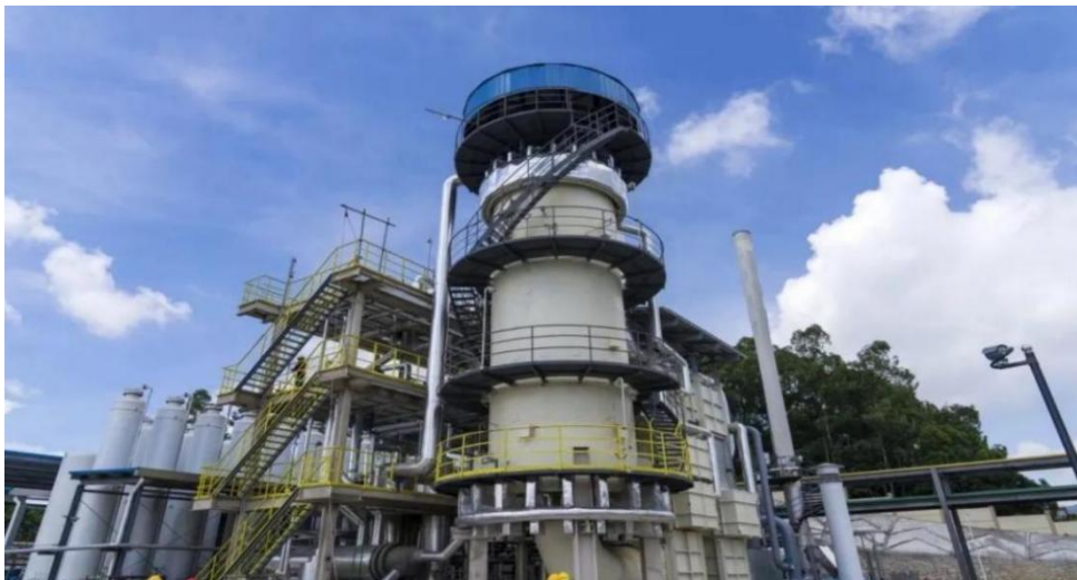
制氢区-氢气转化炉
