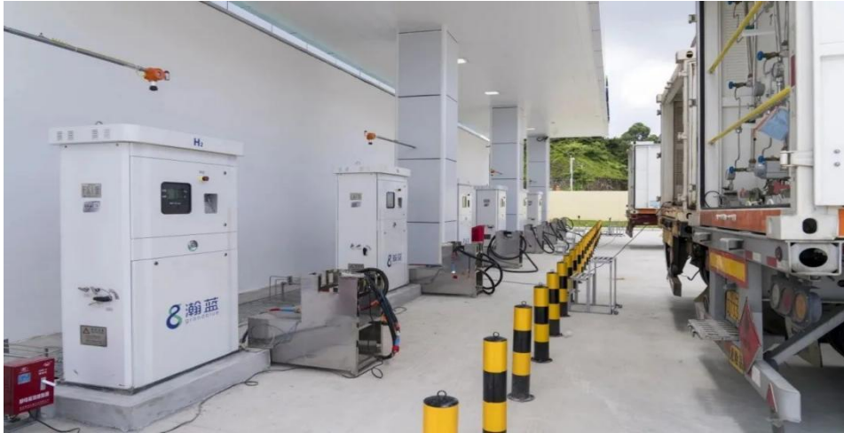
项目内充装区——氢气加氢柱
