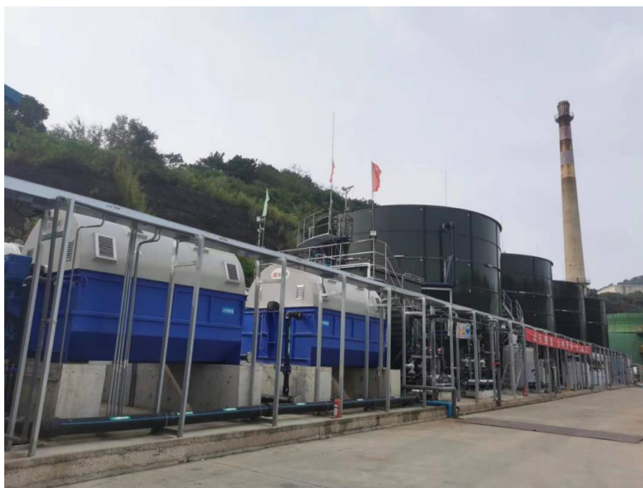
图 3 渗滤液处理设施
